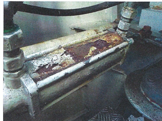
BB Korrodierter Zylinder
