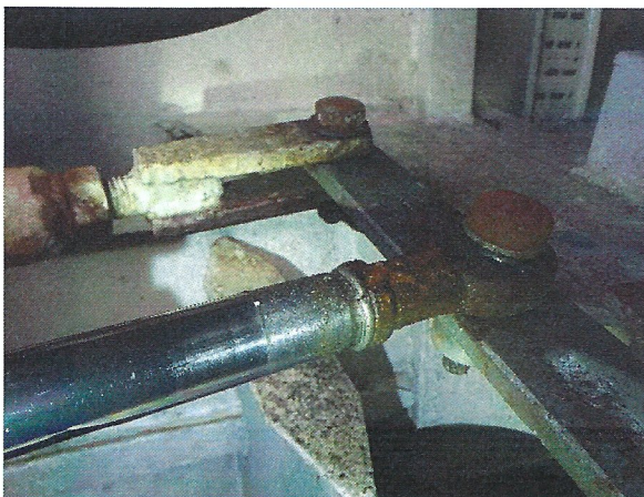
BB Ruder Gestänge / Korrodierter Bolzen
