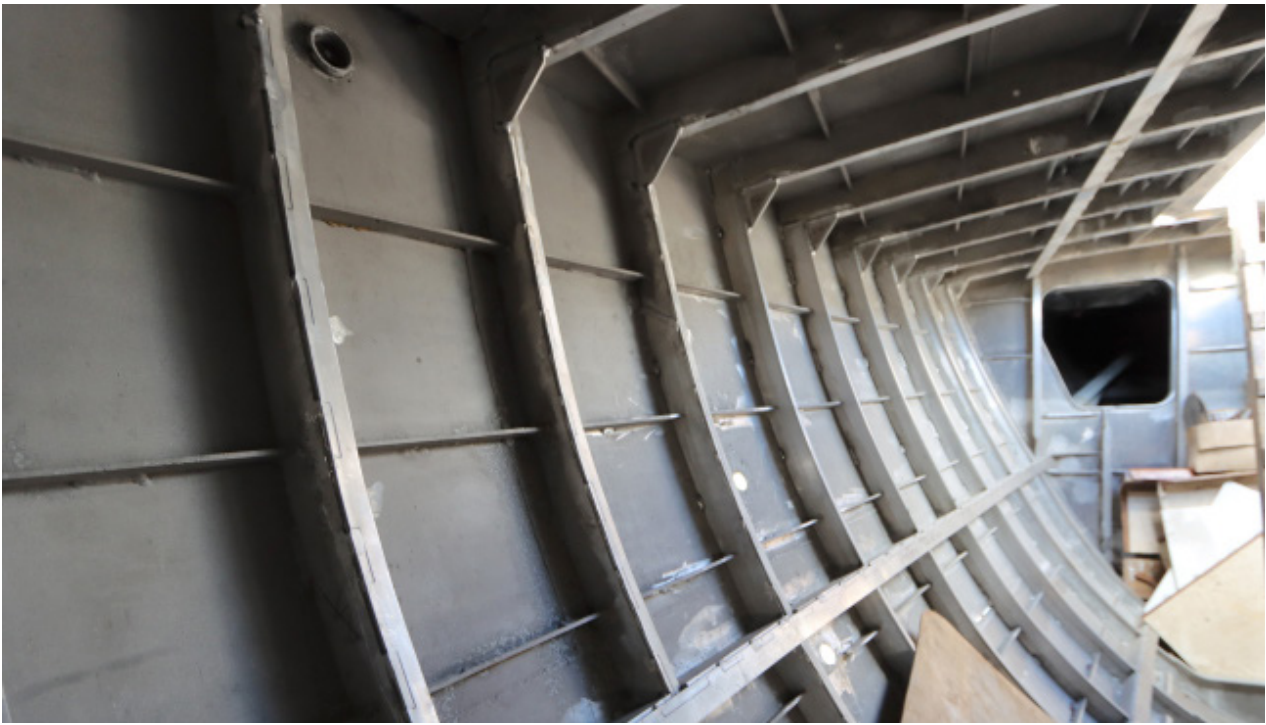
Auch im Inneren des Rumpfes hatten der Zahn der Zeit und reichlich Korrosion ihre Spuren hinterlassen. Auch das Kollisionschot im Vorschiff sowie zahlreiche Spanten wurden bereits erneuert.
