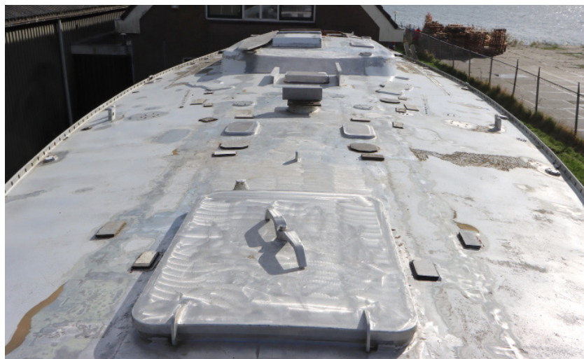
An Deck wurden nach der Demontage aller Beschlüge und Fenster alle Öffnungen provisorisch verschlossen, das große Luk der Segellast ist bereits erneuert.
