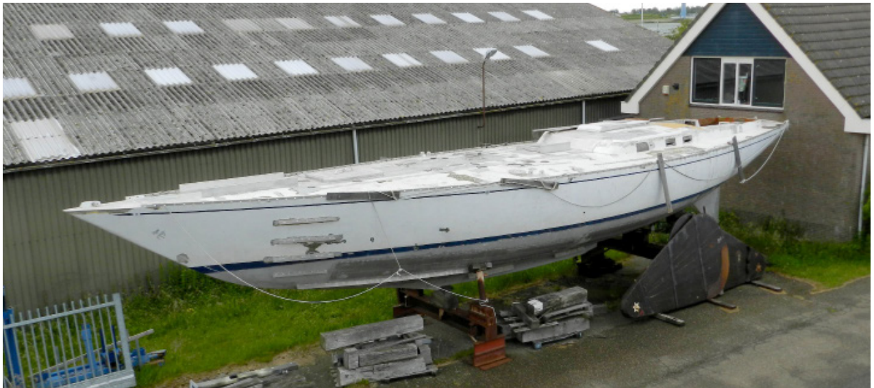
Heute steht TENACIOUS als leeres Kasko auf einer Werft in Enkhuizen, umfangreiche Schweißarbeiten am Aluminiumrumpf machten eine Totalsanierung notwendig. Diese sind schon lange abgeschlossen, im nächsten Schritt könnten Finisharbeiten beginnen.
